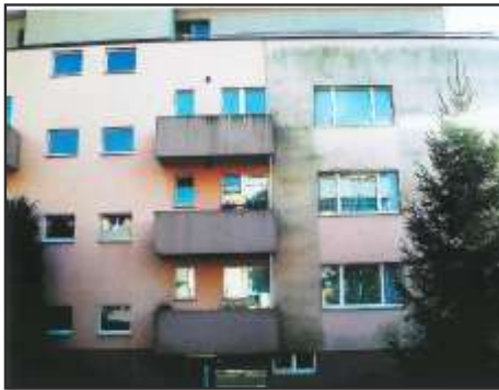
Tauwasserausfall auf einer WDVS-Teilfläche
